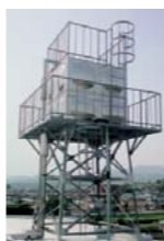
▲屋上に設置された高架水槽
