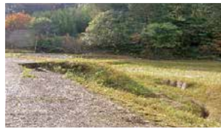
農道（朴木2号線）の被災状況
