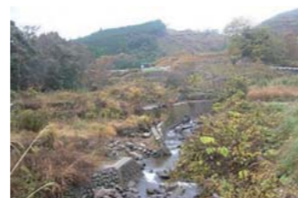
芋ノ八重川（東大塚町）の被災状況
