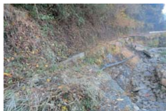
戸越草津線（下戸越町）の被災状況
