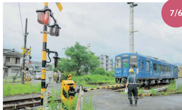
各踏切には作業員が立ち、遮断機の作動状況をチェック
