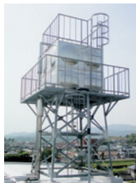
▲屋上に設置された高架水槽
