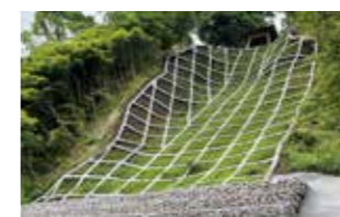
三の丸北側のり面 （人吉城跡）
