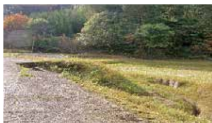
農道（朴免木2号線）の被災状況
