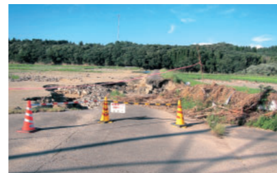
七地地内第2号線 道路流出
