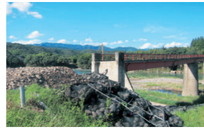
中神大柿線 橋梁破損
