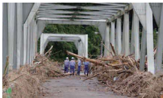
写真-3.6.3 西瀬橋 流出箇所調査状況 10)
