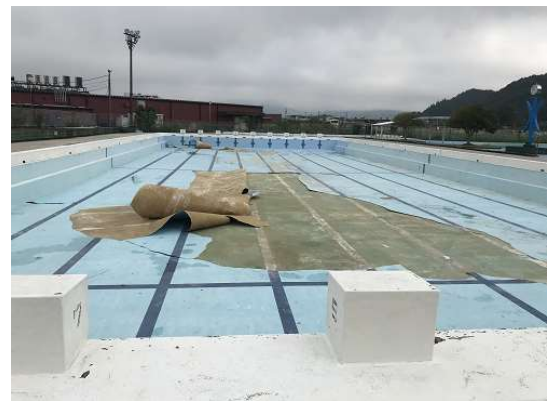
50mプール(人吉市民プール) (令和2年7月豪雨災害・台風10号による被害)
