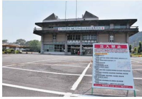
熊本地震で被災した麓町の旧本庁舎
