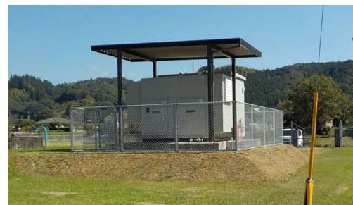
【井ノ口水源地 自家発電設備】
