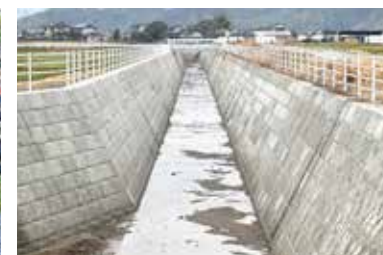
全長1300m、幅4m、深さ4～5mで放水量は毎秒28ト
