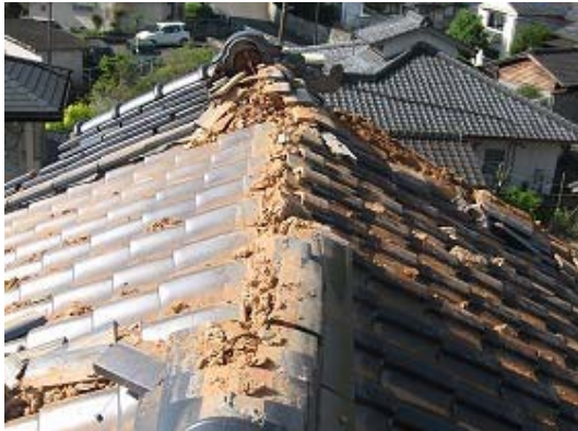
図 人吉市 屋根瓦の損壊(震度5弱)
