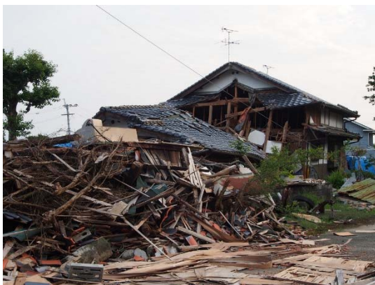
図 益城町 住宅の倒壊（震度 7）
