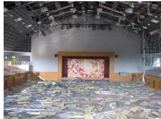
図 益城町 天井材脱落（震度 7）
