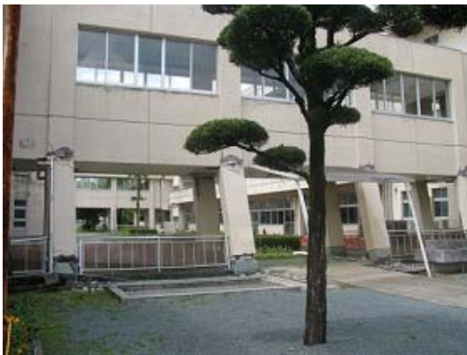
図 益城町 校舎破壊（震度 7）
