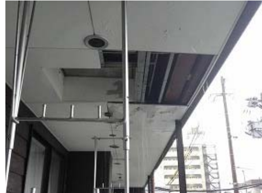
図 人吉市 天井材の脱落(震度5弱)
