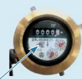
パイロット ▲水道メーター
