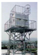
▲屋上に設置された高架水槽
