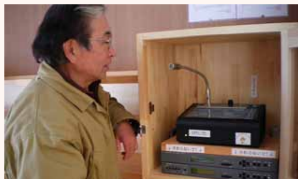
公民館に設置された屋外放送設備
