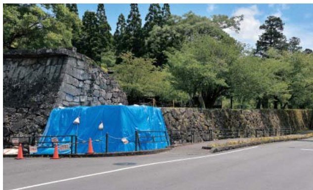
損壊箇所を保護している人吉城跡の石垣
