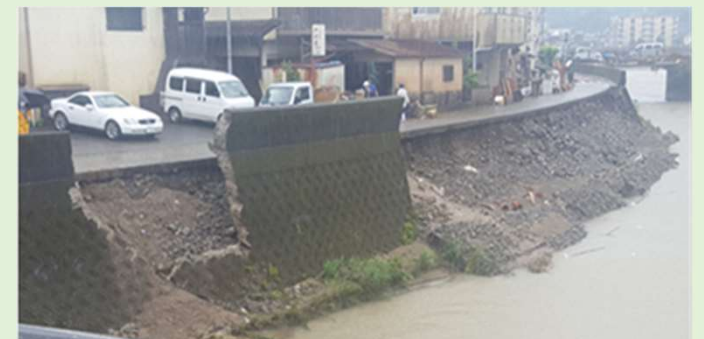
令和2年7月豪雨時の堤防護岸の崩壊状況
