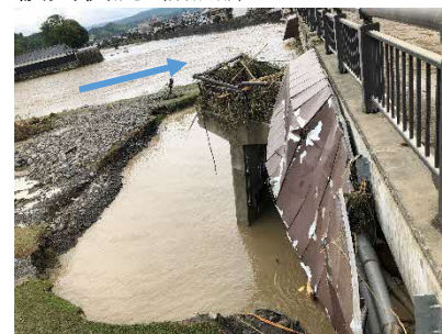
被災状況（階段部）
