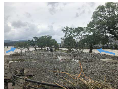
被災状況（大橋より下流側を臨む）
