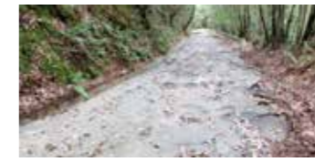
林道(林道園田山線)の被災状況
