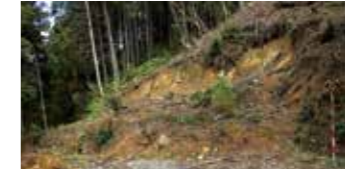
林道(林道大谷線)の被災状況
