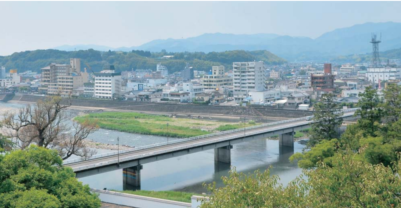
補修工事に向け協議を進めている水ノ手橋
