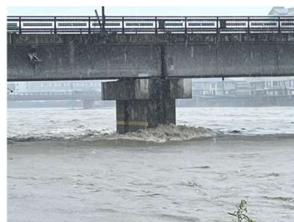
中川原浸水時の水の手橋状況（R5.7月）
