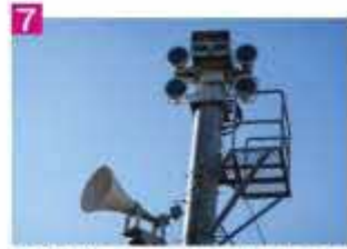
7 空間監視カメラ・警報装置 大雨の時や通常時において河川や施設の状況を遠くから監視しています。また、大雨の防災情報も提供しています。
