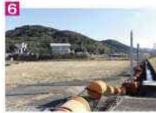
6 網場 水位が上がるとボールに沿って網が上昇し、洪水によって流れてくる木やゴミが遊水地内に入ってくるのを防ぎます。
