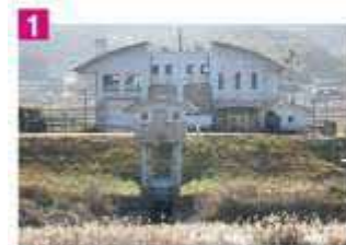
1 排水機場 【排水能力5m³/秒】 遊水地内の水を強力なポンプで牛津川に排水します。
