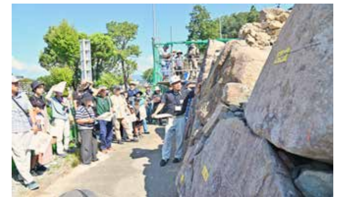
石垣が膨らんでいる様子を見学した参加者
