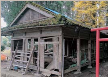
▲令和2年7月豪雨災害での被災直後の神所
