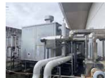
大アリーナ空調熱源装置
