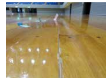
損傷を受けた大アリーナの床
