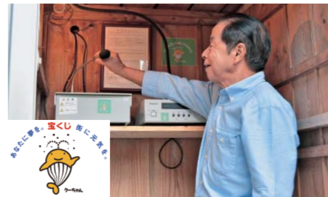
矢黒公民館に新しく整備した放送設備を利用する川野町内会長
