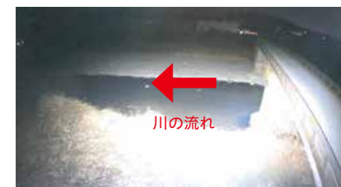
照明設備設置後
