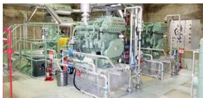
災害復旧を進める下水道施設
