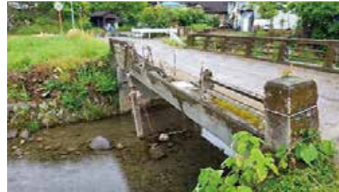
永野橋（下永野町）の被災状況
