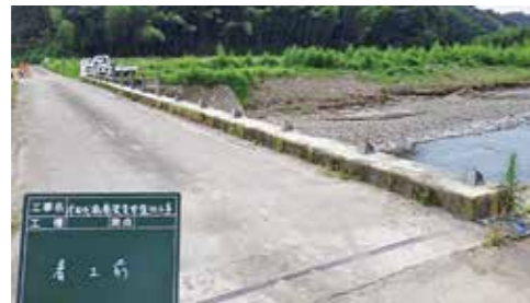
才田代橋（下田代町）の被災状況
