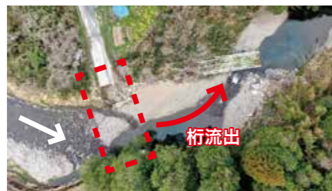
麓橋（大畑町）の被災状況
