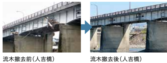
流木撤去前(人吉橋)
