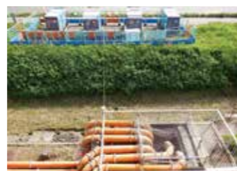
頭無川雨水ポンプ場の仮設ポンプ施設
