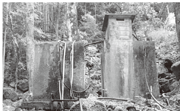
台風15号で被害を受けた古仏頂町下村飲料水供給施設
