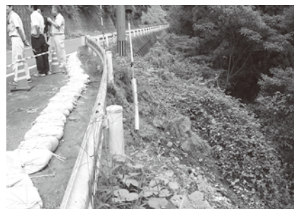
復旧工事が行われる市道戸越鹿目線
