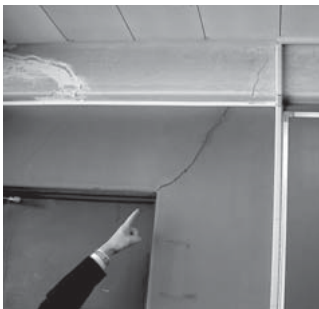
本庁舎内に入った亀裂
