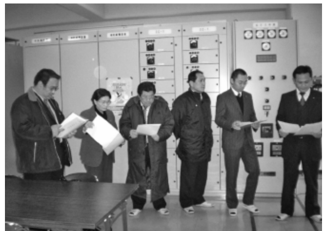
頭無川雨水ポンプ場を視察する厚生委員会
